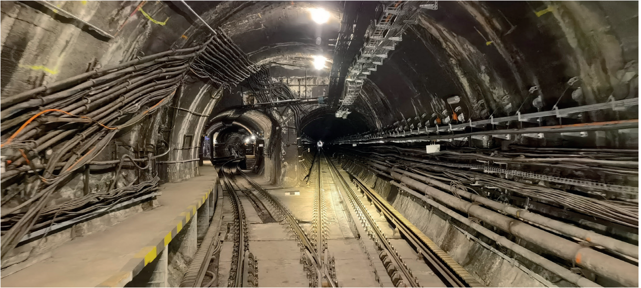
Budapest, M3 metró, Deák Ferenc tér, kihúzó [fényképezte: Random photos 1989, 2023.12.17., https://commons.wikimedia.org/wiki/File:Budapest,_M3_metró,_Deák_Ferenc_tér,_kihúzó,_5.jpg ]
