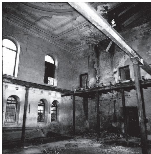
7. ÁBRA: A papréti ortodox zsinagóga belső tere 1980-ban, beszakadt mennyezettel, a női karzat öntöttvas oszlopaival [18]
