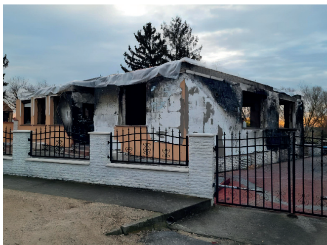
12. ÁBRA: A tűzkár súlytotta lakóépület a hiányzó tetőszerkezettel
