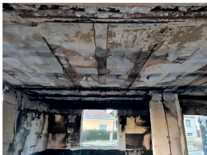
13. ÁBRA: A földszint feletti födém és a falak állapota a tűzkár után
