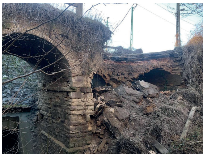
5. ÁBRA: A piliscsabai híd tönkremenetele, az erős mállás helyén [28]
