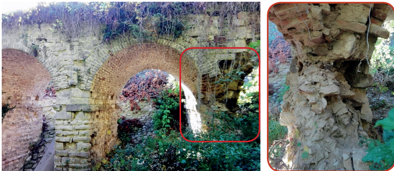
6. ÁBRA: Erősen mállott pillérek a piliscsabai hídon, jól látható a károsodás helye, ahol a tönkremenetel be fog következni (évekkel az összeomlás előtti felvétel)
