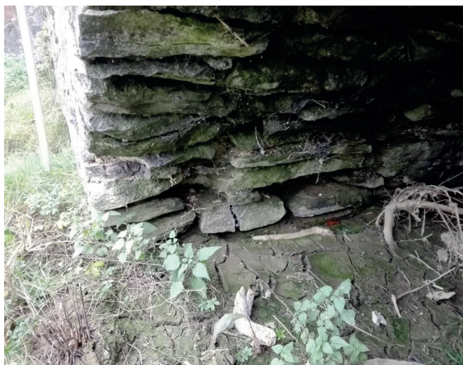
1. ÁBRA: Habarcschiány a pulai híd intradoszán
