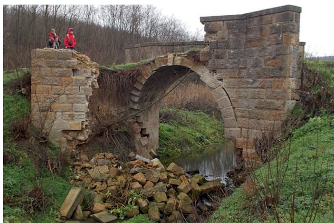
4. ÁBRA: A felsőpetényi híd [27] tönkremenetele
