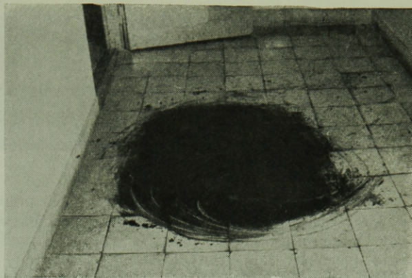
4. fénykép. A kész mozaikpadló-burkolaton helyszíni bedolgozásra műkö anyagot nedvesen keverték. A burkolaton az abba belekötött cement csúnya és tartós foltot hagyott vissza
