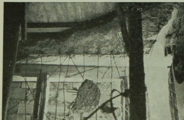
4. ábra. Egerben, Dobó István tér 4 sz. alatt leszakadt salakbeton födém. A vaskötegek korrodálódtak el a tartók melletti kengyeleknél
