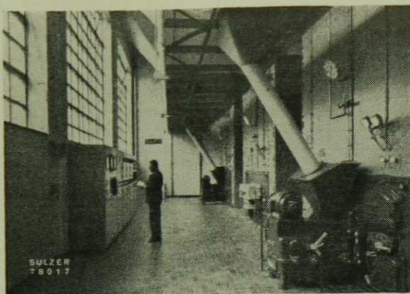
5. ábra. Kazánház. A három kazánból a két szélső szén-, a középső olajüzemű
