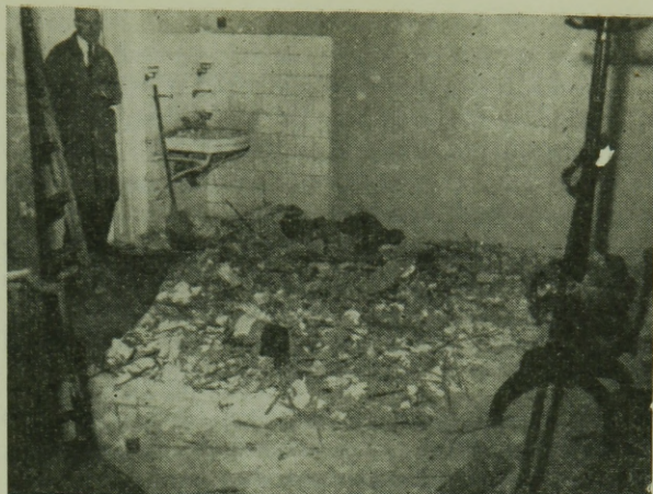
3. ábra. A 2. fényképen látható letáskásodásnál leesett salakbeton törmelék
