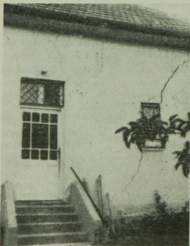
2. ábra. Térfogatváltozásból eredő épületkár (Farkasrét)
