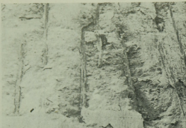
9. fénykép. Betonletáskásodások a hűtőtorony falán
