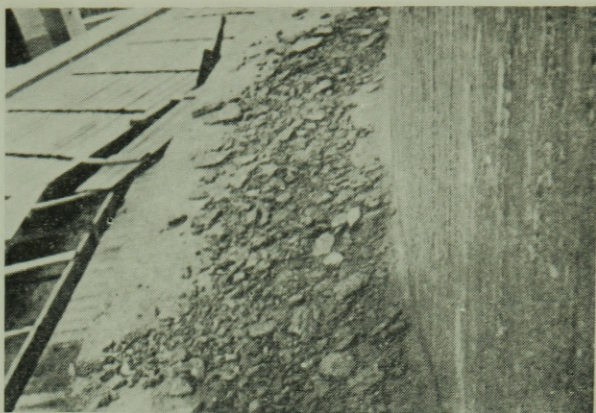
4. fénykép. Letáskásodásokból eredő betontörmelék az Ajkai Erőmű hűtőtorny körüljáróján
