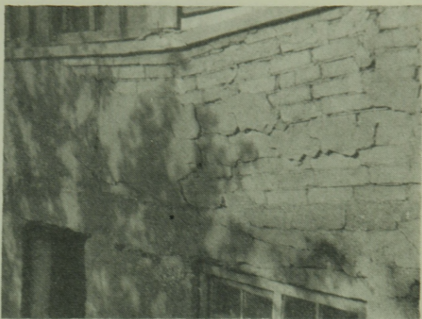
4. ábra. Bányakárt szenvedett lakott épület vasbeton födémmel
