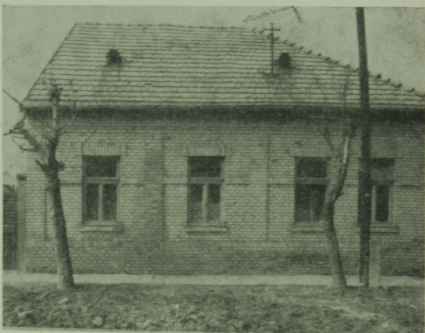
12. ábra. Vízköpös ereszesatorna a régi repedésekkel szinte különálló részekre tagolódott házon
