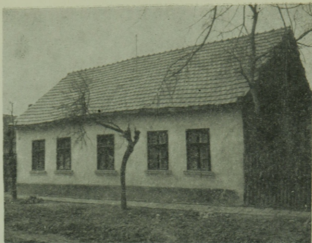
11. ábra. Eltorzult tetősíkok és nyílászáró keretek; régi repedések javítás-nyomai
