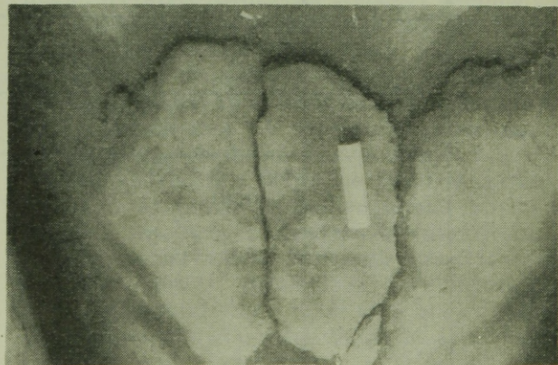
2. ábra. Meghibásodott csatornaszakasz
