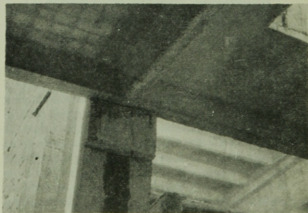
1., 2., 3. kép. Szárazon összeépített, minimális felfekvési felületű vasbeton elemek alátámasztásánál fellépő repedések
