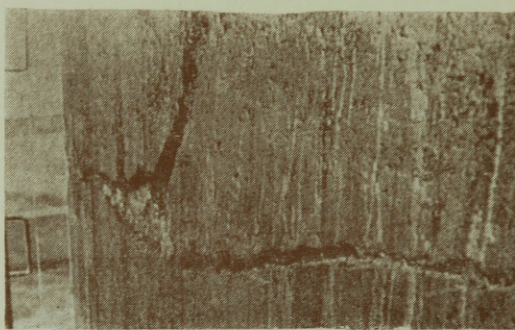
49. ábra. 19—21. támrudak térségében (kívül) nagymérvű felszakadások nyomai
