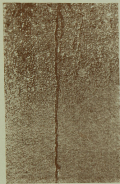
52. ábra. A lecsurgó cementhabares a színezett felületet beszennyezi
