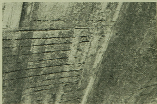
2. kép. Gondatlan kivitelezés miatti hiányos betontakarás
