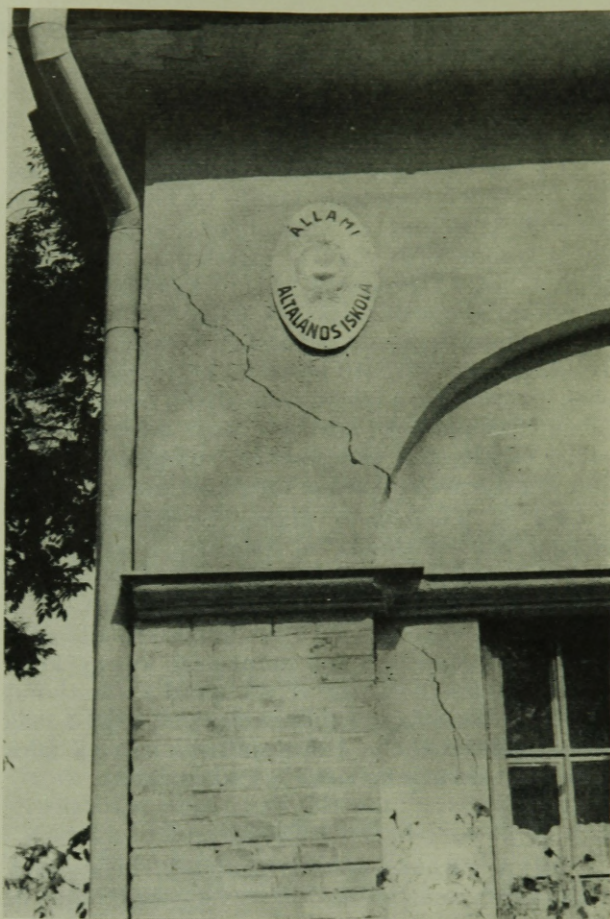
2. ábra. Nagybátony. Alábányászás következtében fellépett épületkár
