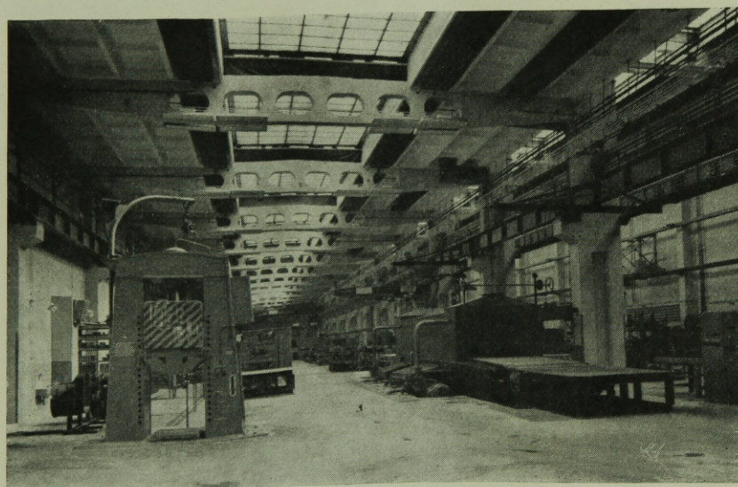
6. ábra. Ipari csarnok sugárzóernyős fűtéssel
