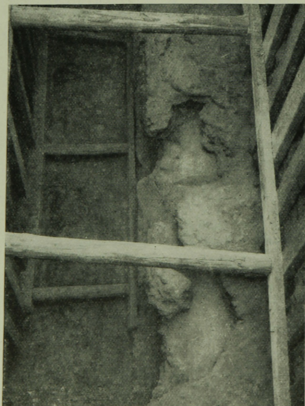
3. ábra. Javítás után feltárt \varnothing 30 cm belméretű csatorna
