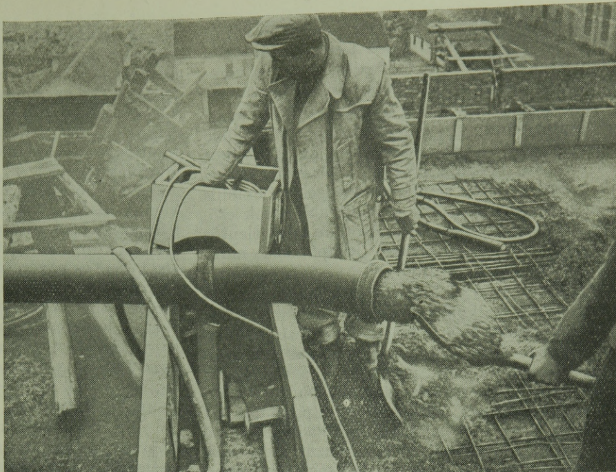
5. fénykép. Betonanyag kiömlés a csővégződésnél
