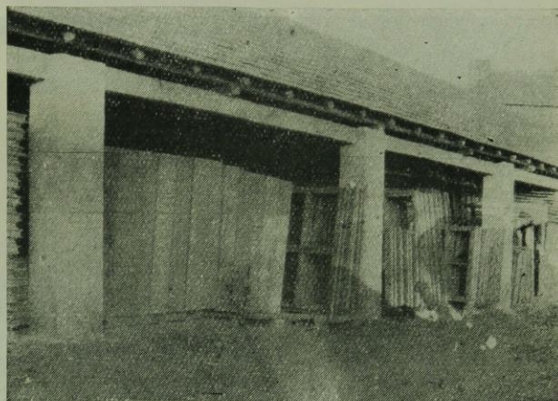
6. ábra. Épületasztalosipari gyártmányok szakszerűtlen tárolása.
