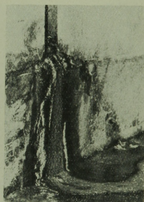
13. ábra. A tágulási hézagon kiömlő gyümölcslé, mely a betonfalból kimosott szabad meszet is magával hozza, a lábazatot és padlót mélyen kimarta.
