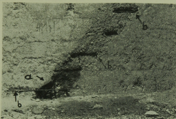
6. ábra. Vakolat leverés után előtűnt ferde munkahézag. A ritka betont a savmarás gyorsan és nagymérvben tönkretette (a), mellette a jó minőségű beton szinte érintetlen. A savmarás a vasak mentén a legnagyobb (b). Elő bizonyítéka ez annak, hogy a konzervipari gyenge savak hatása a jóminőségű betonra rövid idő alatt csekély, a rosszra viszont aránytalanul nagy.
