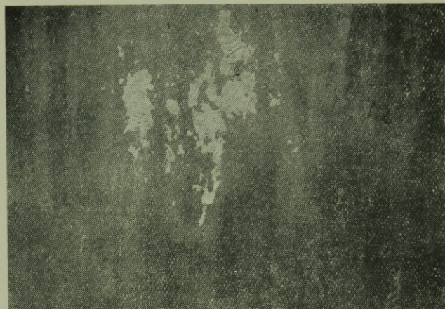
1. ábra. Parafin-cerezin bevonat lehámlása; oka: a vakolatba való beszívódás hiánya. Korrozíós jelek a betonon még alig mutatkoznak.
