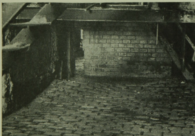
5. ábra. Kénsavfolyás következtében felpúposodott keramitburkolat.
