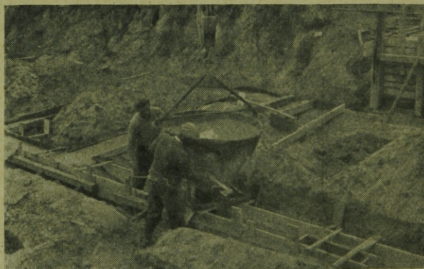
9. kép. Tölcséralakú betonkonténer.
