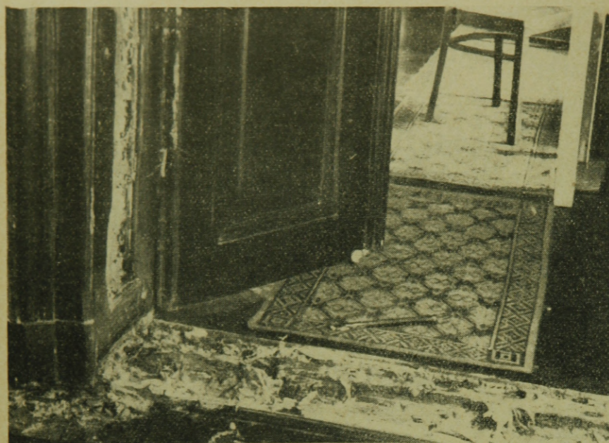
5. ábra. A szanálás elégtelenségének következménye: súlyos gombásodás
