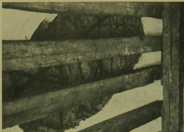
5. ábra. Részben leszakadt födémtest aláfogása, a vasbetétek jól látszanak
