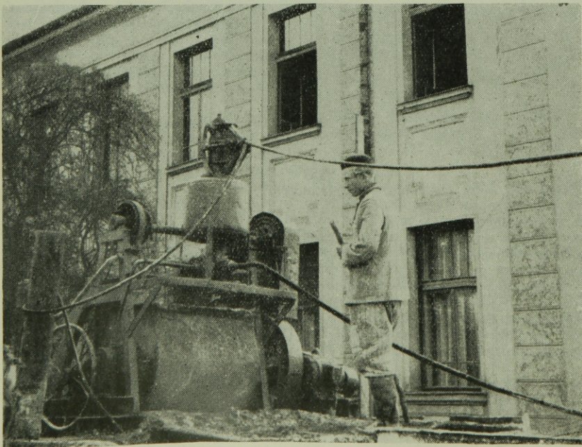
1. ábra. Gondozatlan habarcskeverőgépet szabálytalanul a gépre kötött gumikábelrel. Túlzsúfolt, nem biztonságos gépkezelő állás
